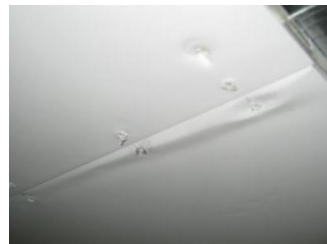
図4 仕上げ材の損傷(継目部分)【フラットタイプ】
