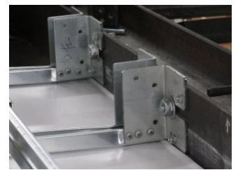
図5 野縁・仕上げ材の局部座屈(端部固定箇所)【フラットタイプ】
