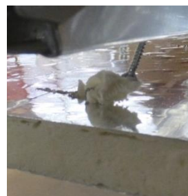
図8 仕上げ材の損傷状況(ビス周り)【エンボスタイプ】
