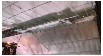
(a) K-NET 仙台波 50%加振後(未対策天井)
