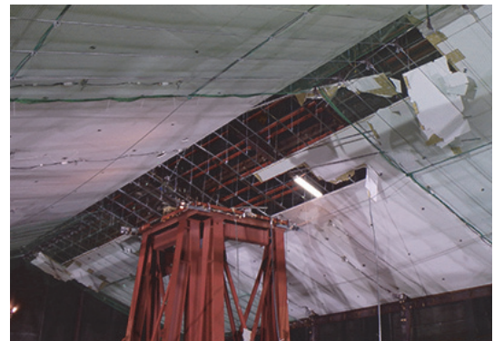
写真3 天井脱落状況全景
