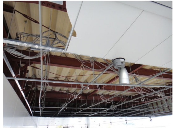
写真1 台風による天井被害事例
