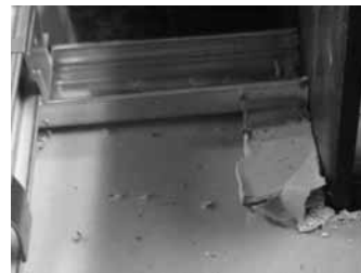
写真 3 下地材の圧壊(T-1)
