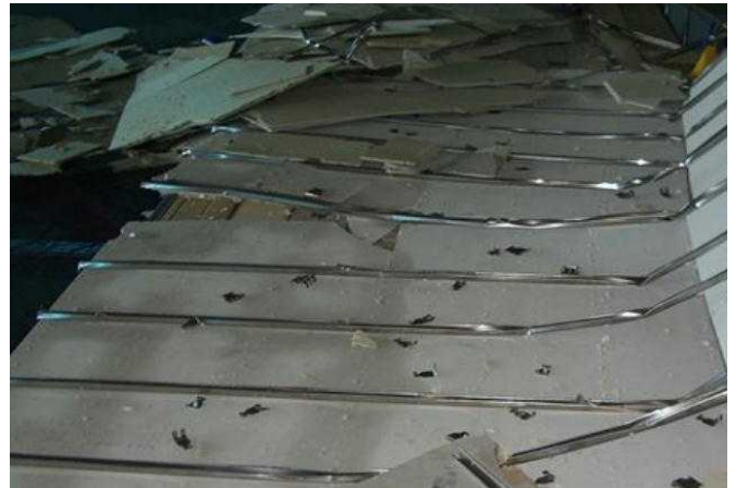
写真1 天井被害状況
